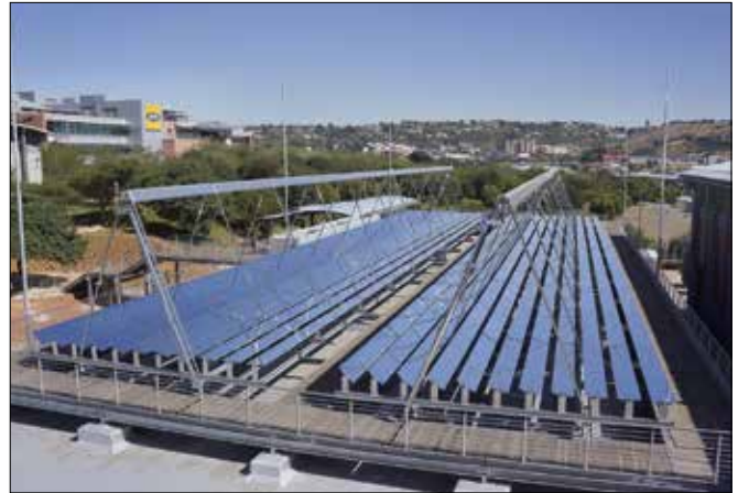
Die Anlage bei MTN verfügt über 484 m 2 Kollektorfläche – 484 m 2 collector surface area on MTN's roof
